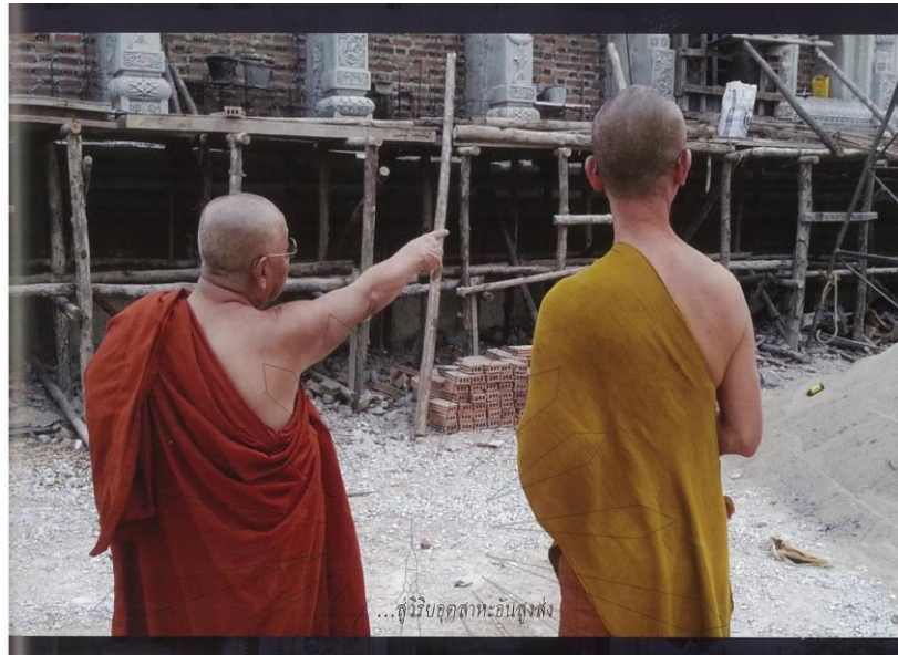
รูปภาพ ภาคผนวก ก ที่ 5 พระเทพปริยัติมงคล ควบคุมการก่อสร้าง
